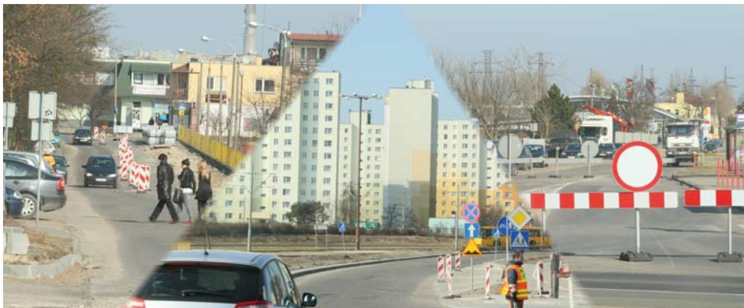
Od lewej: Wyszyńskiego i Konstytucji 3 Maja są w remoncie. Wewnątrz numeru piszemy też o zmianach w organizacji ruchu związanych z budową mostu, które wpływają na kwestię dojazdu na nasze osiedle.
