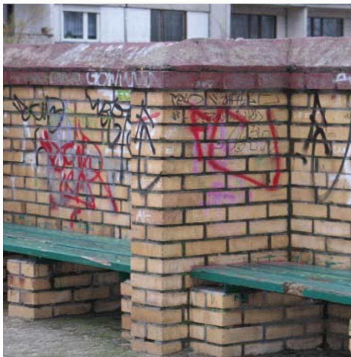
Zniszczone ławki w sektorze CHU
